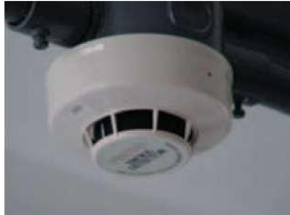
Figura 34 – Detector de incêndio
