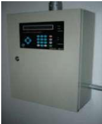
Figura 37 – Central de alarme
