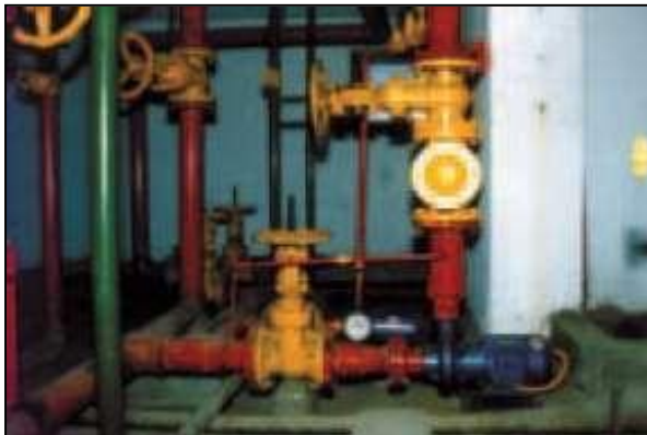
Figura 43 – Bomba de incêndio e acessórios hidráulicos
