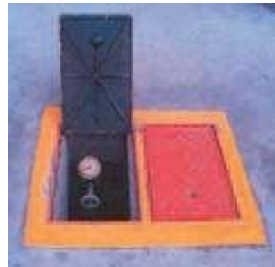
Figura 41 – Registro de recalque para bombeiros
