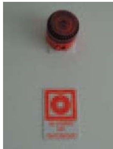
Figura 36 – Detalhe de sirene
