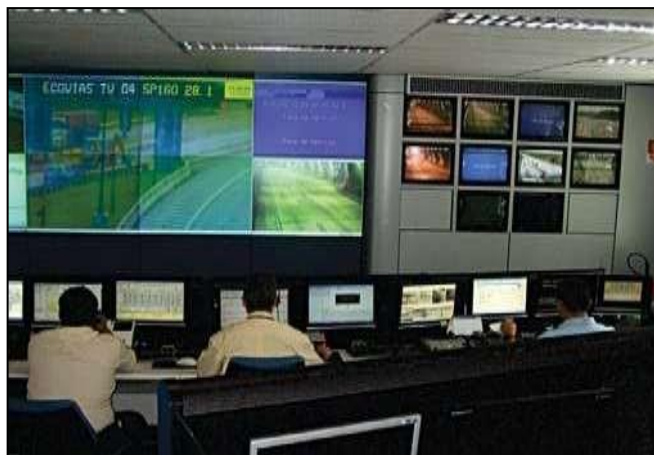
Figura 3 – Central de monitoramento
