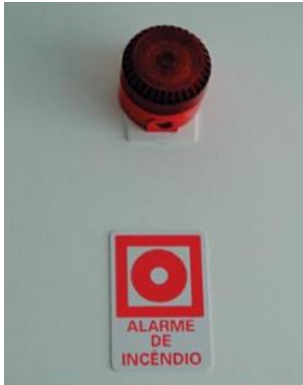
Figura 35 - Detalhe de sirene
