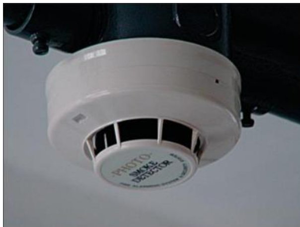
Figura 33 - Detector de incêndio
