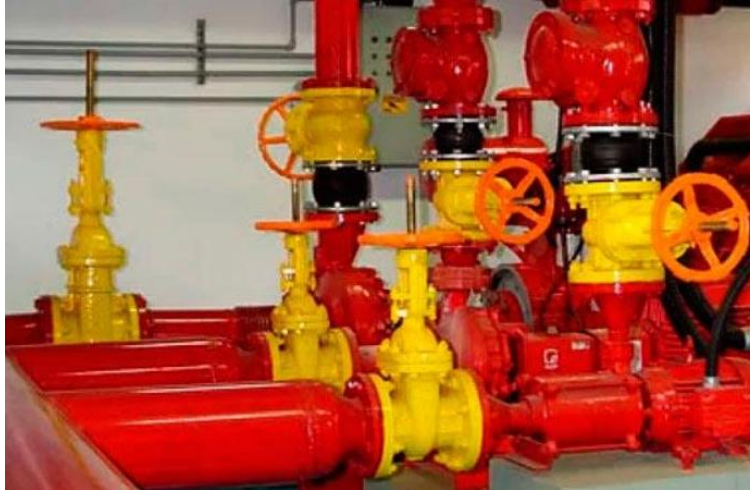
Figura 41 - Bomba de incêndio e acessórios hidráulicos
