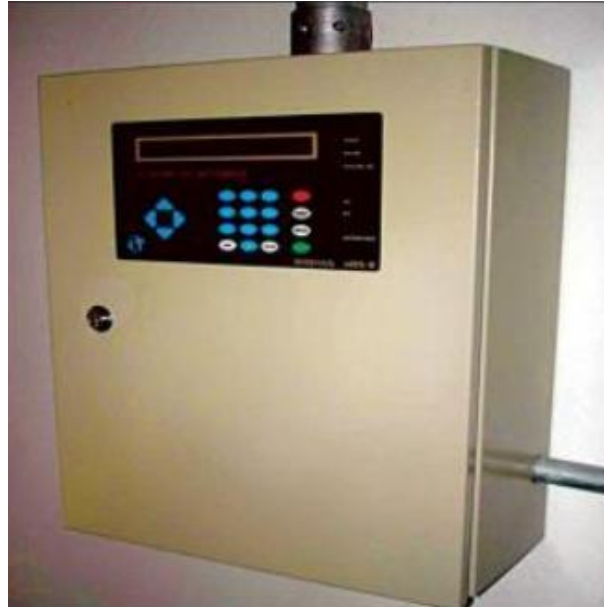
Figura 36 - Central de alarme
