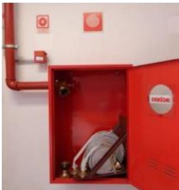
Figura 38 - Detalhe de hidrante
