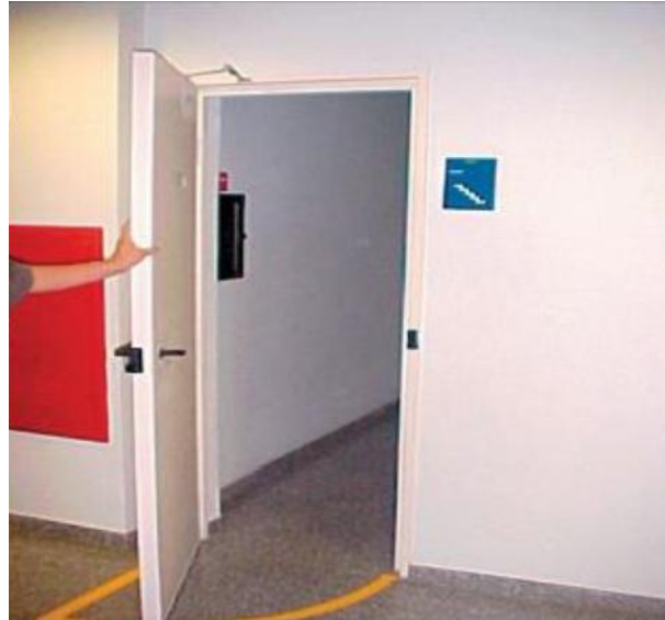
Figura 29 - PCF em corredor
